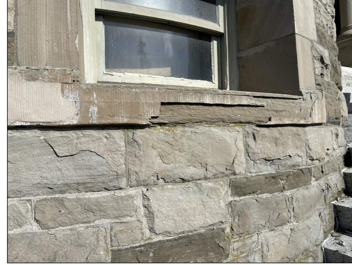
7 SPALLING SILL FACE SCALE: NTS
