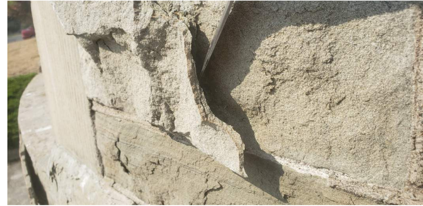
2 SPALLING FACE SCALE: NTS
