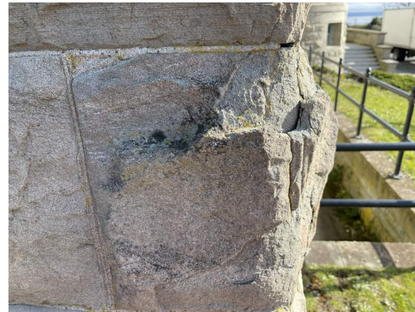
11 SPALLING CORNER STONE SCALE: NTS
